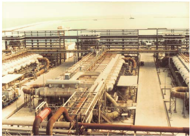
サウジアラビア / アルジュベール 海水淡水化プラント
