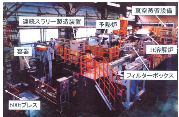
写真 - 2 トータルシステム実証研究設備全景写真
