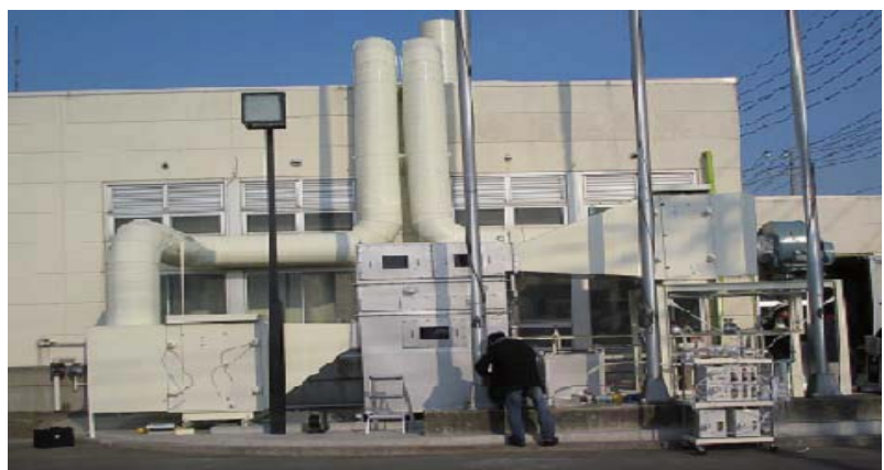
図3 塗装工場に設置したVOC除去処理装置の概要図及び外観
