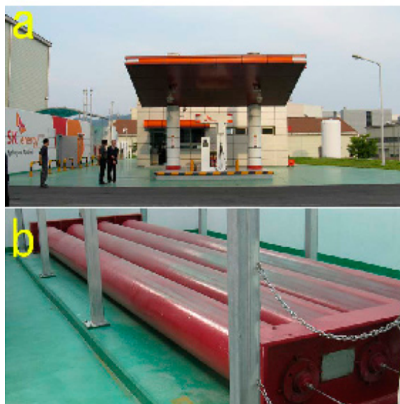
図2 SK Energy水素ステーション (a: 全景、b: 蓄圧器)
