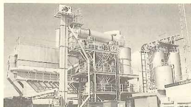
舗装廃材のリサイクルプラント「トップドラム」
