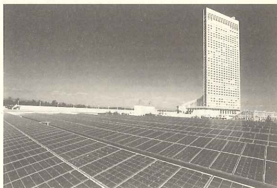
普及が進む太陽光発電システムの設置例 (今後は、薄膜系、建材一体型太陽電池へと進展)
